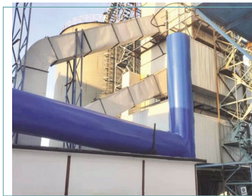
蓝色管道为乏气余热回收总管道
